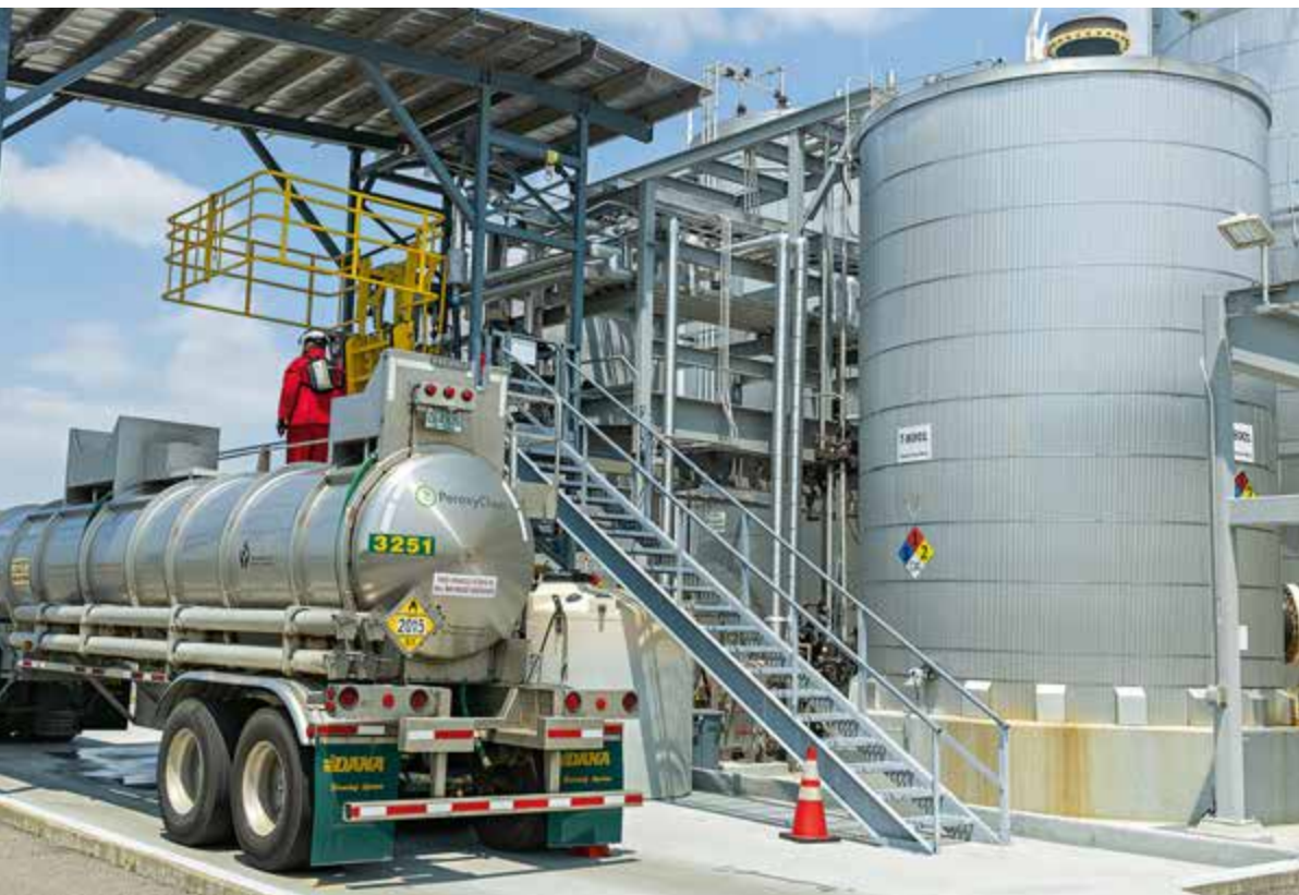
Ein Mitarbeiter bereitet das Entladen von Wasserstoffperoxid für die Herstellung des Desinfektionsmittels Peressigsäure in der Evonik-Anlage am Wolf River vor.
