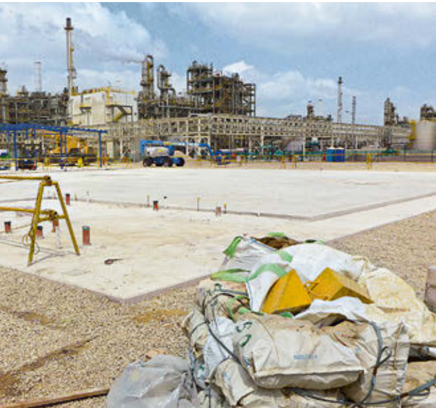
Die Arbeiten für die Erweiterung der Methioninanlage laufen bereits. Im kommenden Winter sollen die neuen Komponenten in den bestehenden Prozess integriert werden.
